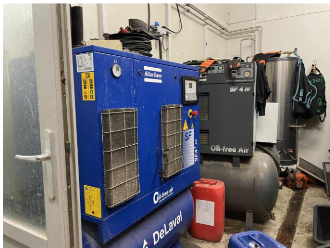
Bygning 9, kompressorer til malkerobotterne
