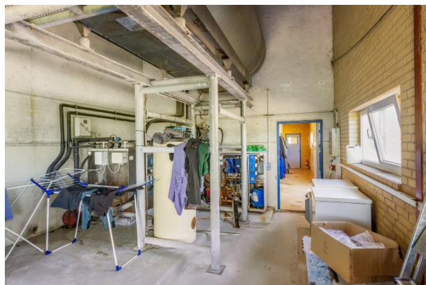
Teknikrum og buffertank
